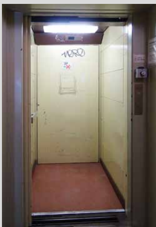
Aufzug Wilhelmstraße 47e vor der Modernisierung
