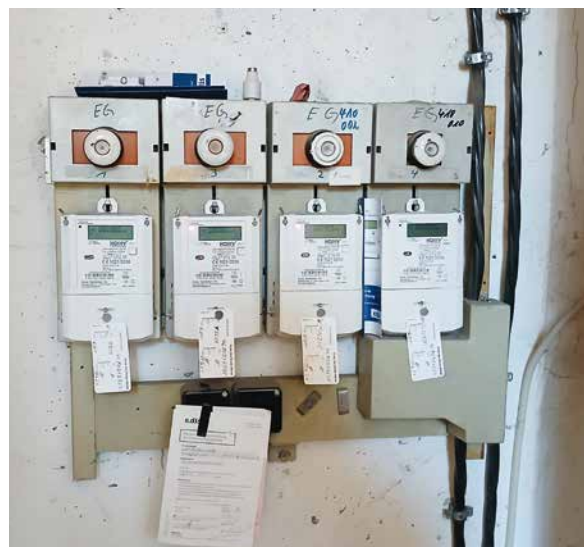
Alter Stromhausanschluss mit modernen digitalen Stromzählern
