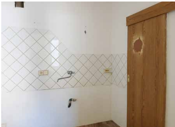
Fliesenspiegel in der Küche vor der Sanierung
